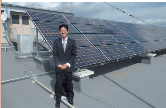
◀新庁舎屋上の太陽電池パネル
