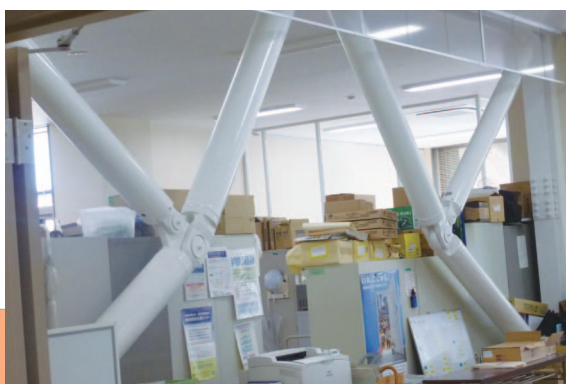
◀執務室内の油圧式ダンパー
